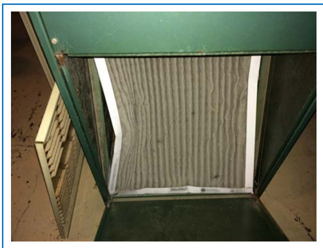
Figura 8. Ejemplo de gran cantidad de flujo de aire de derivación alrededor de un filtro en una unidad de manejo de aire debido a una instalación inapropiada combinada con carga excesiva que incrementa la caída de presión a través del filtro más allá de lo que el filtro era capaz de soportar. Fotografía cortesía de Brent Stephens.
